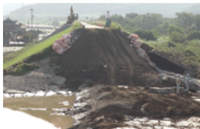
小田川破堤箇所(2018年7月11日草島進一氏提供)
